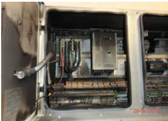
Bild 5-4: Mit Rauch kontaminierte Schalteinrichtung
