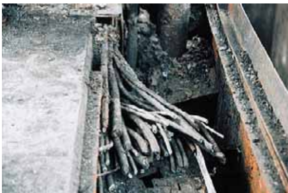
Bild 2-2: Kabel mit PVC-Ummantelung setzen im Brandfall große Mengen an korrosiven und toxischen Schadstoffen frei. (Bild: schaden 2/1997, © IFS e. V.)
