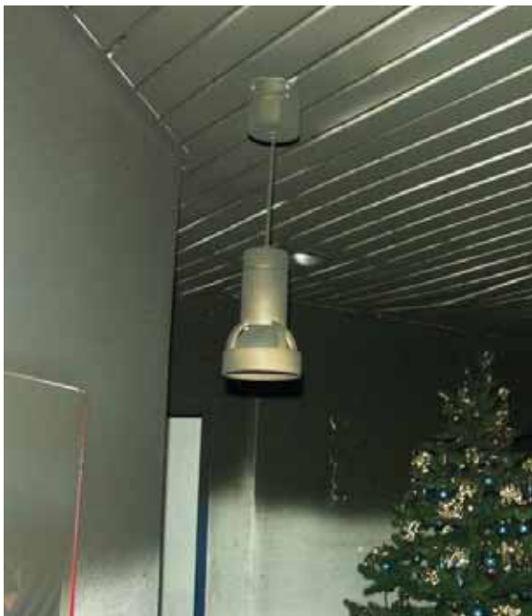
Bild 5-1: Rauchbeaufschlagung in einem Büroflur (Bild: Brechler.Kiküm.Klein GmbH, Warendorf)
