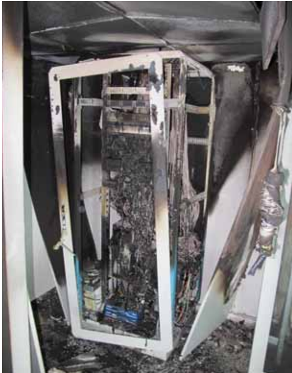
Bild 5-3: Dieser ausgebrannte Serverschrank steht einzeln in einem brandschutztechnisch wirksam abgetrennten Raum (hier feuerbeständig und rauchdicht). Der Brand wurde somit auf den Serverraum begrenzt, die benachbarten Bereiche wurden nicht durch Rauch und Brandfolgeprodukte geschädigt.
