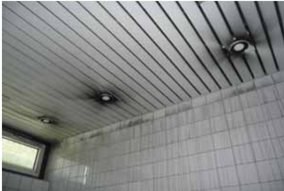
Bild 5-10: Über eine nicht abgeschaltete Lüftungsanlage wurde der Brandrauch in großen Mengen auch in vorher nicht vom Brand betroffene Nebenräume übertragen. (Bild: Brechler.Kiküm.Klein GmbH, Warendorf)
