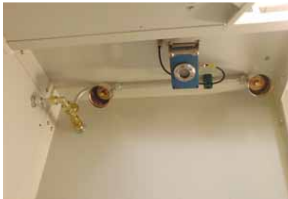
Bild 6: Flammmelder, Wärmemelder und Löschdüsen im Bearbeitungsraum einer Werkzeugmaschine (Quelle: Minimax GmbH&Co.KG)
