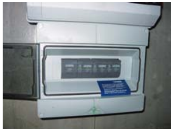
Bild 9: HV mit Überspannungsschutz Typ 1 + 2
