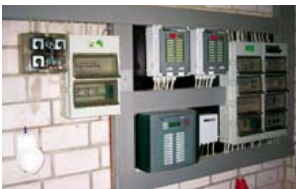
Bild 5: Lüftungssteuerungs- und Überwachungsanlage
