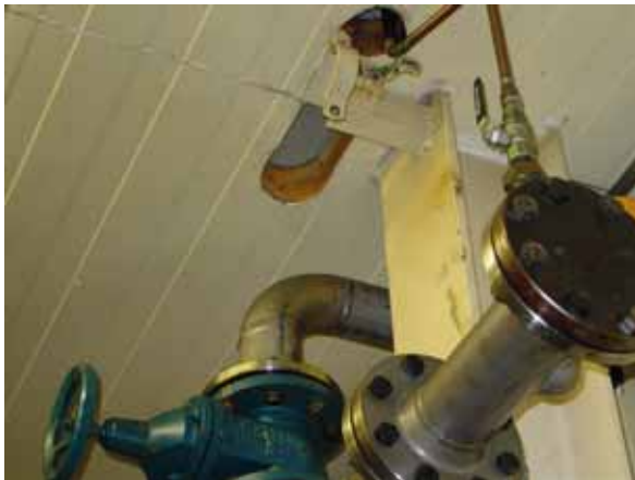
Abb. 6-8: Beispiel einer ungeschützten Öffnung im Sandwichelement mit brennbarem Dämmstoff
