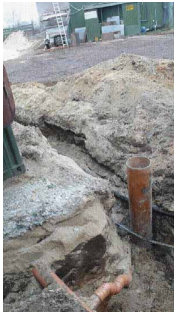
Bild 19: Unzulässiger Einsatz von KG-Rohren als Biogasleitung
