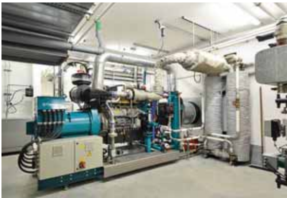
Bild 11: BHKW in Maschinenaufstellraum
