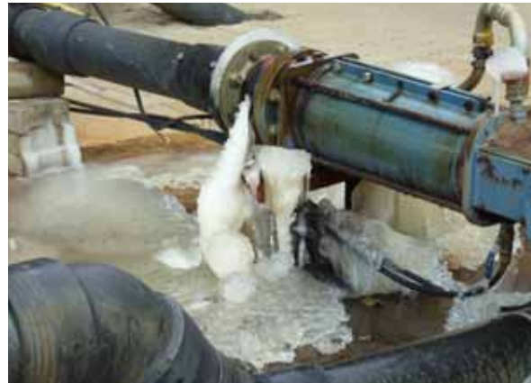
Bild 9: Durch Frost beschädigte Pumpe
