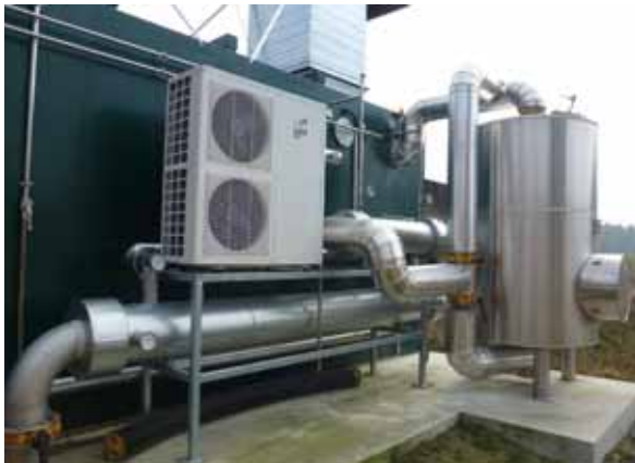
Bild 10: Gaskühlung und Gastrocknung
