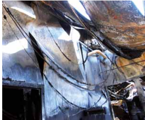
Abb. 10: Sandwichelemente und Elektroinstallationen nach einem Brand (Beispiel).
