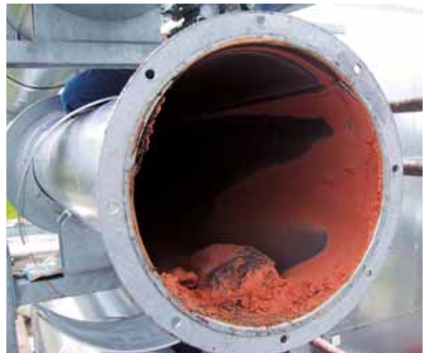
Abb. 6: Eine Lüftungsleitung mit Ablagerungen, die eine Brandausbreitung begünstigt.
