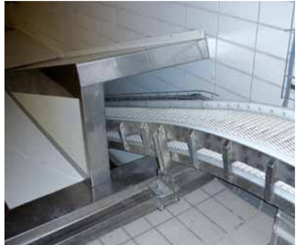
Abb. 5: Durchbruch in einer feuerwiderstandsfähigen Decke durch eine Förderanlage.
