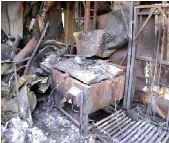
Abb. 8: Eine Industriefritteuse verursacht einen Totalschaden auf Grund unzureichender Schutzmaßnahmen.
