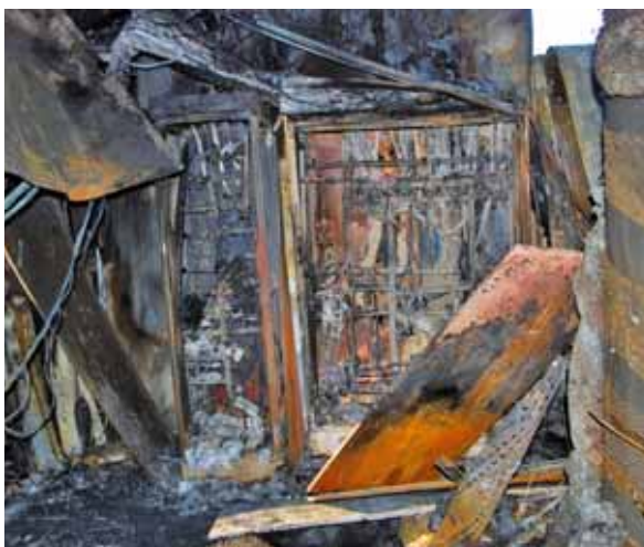
Abb. 9: Beispiel eines ausgebrannten Schaltschranks (Elektroanlagen und -installation als eine typische Schadenursache).
