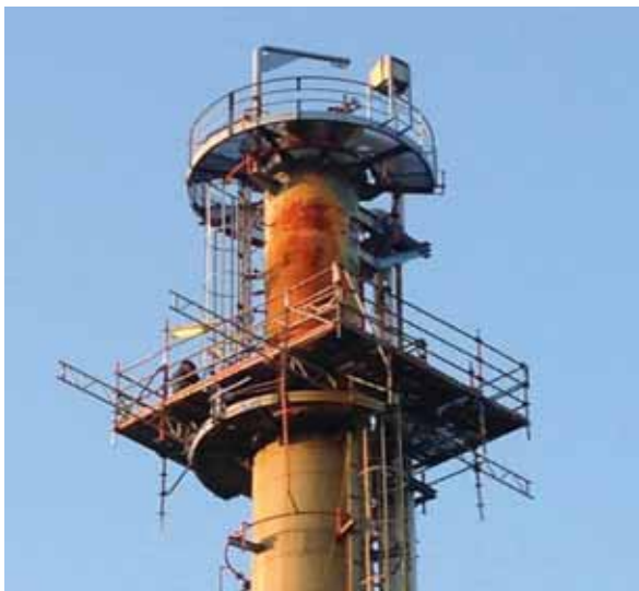
Bild A6-7: Nach Demontage der Isolation: starke thermische Belastung des Kolonnenmantels
