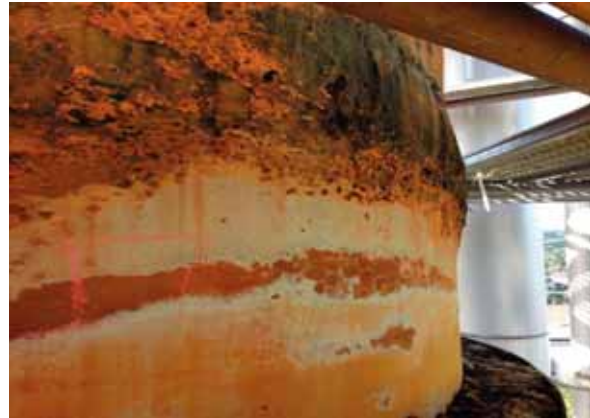
Bild A6-8: Plastische Verformung des Kolonnenmantels
