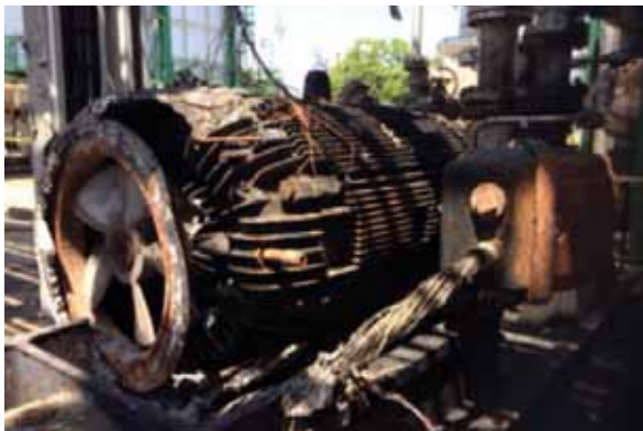
Bild A6-3: Beschädigte Pumpe
