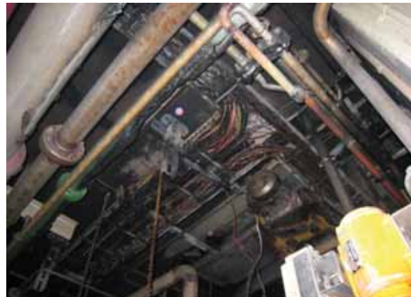
Bild A6-4: Brandschaden Kabeltrasse (Quelle: Merck KGaA, B. Saßmannshausen)
