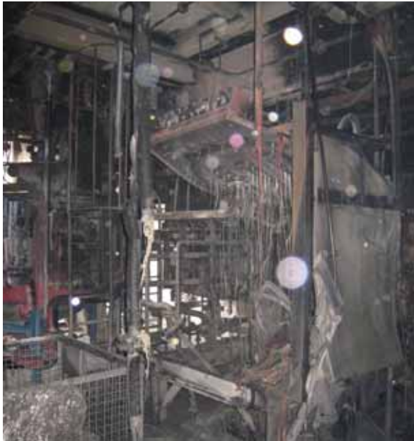
Bild A6-6: Brandschaden Kabine (Quelle: Merck KGaA, B. Saßmannshausen)
