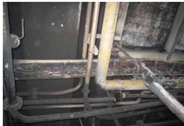
Bild A6-5: Brandschaden Kabeltrasse (Quelle: Merck KGaA, B. Saßmannshausen)
