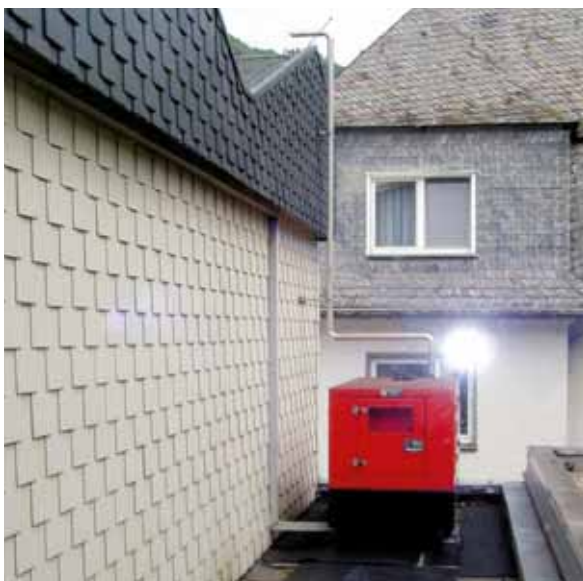
Abb. 4: Beispiel für ein Notstromaggregat (Quelle: R+V Allgemeine Versicherung AG)
