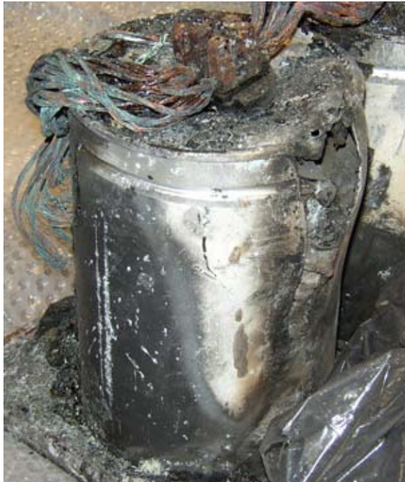
Abb. 4: Geplatzer Druckbecher eines Netzfilter-Kondensators (Bildquelle: Allianz)
