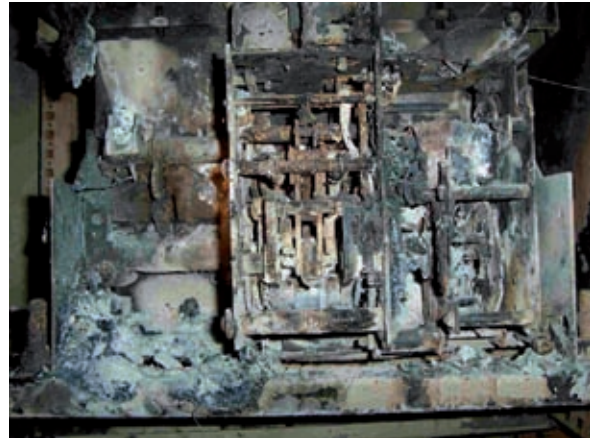
Abb. 3: Leistungsschalter einer 1 MW-WEA – zerstört durch Brand (Bildquelle Allianz)
