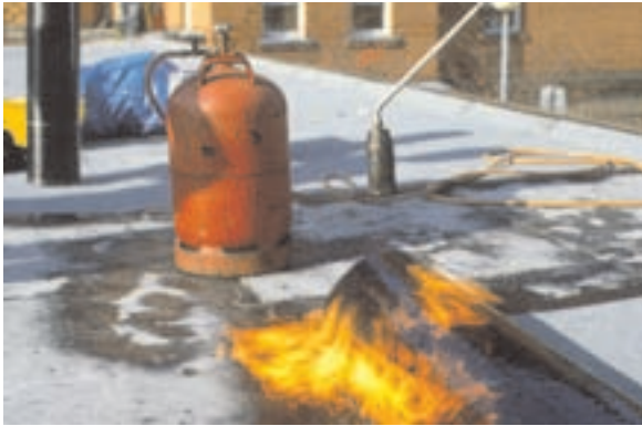
Abb. 4: Arbeiten mit offenem Feuer auf einem Dach – So nicht!
