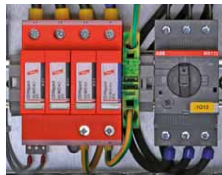
Installation im Verteiler (Quelle: DEHN)
