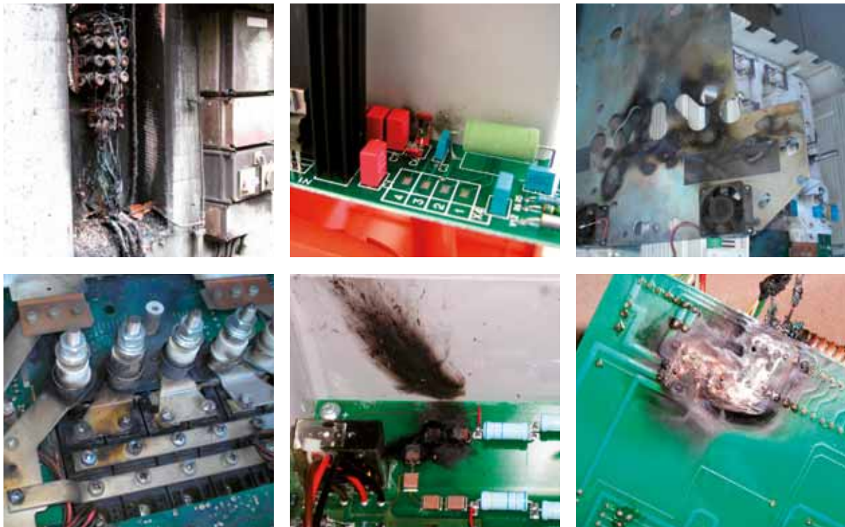
Bild 16: Beispiele von Schäden in elektrischen Anlagen und elektronischen Betriebsmitteln (Quelle: Lutz Erbe, VGH)
