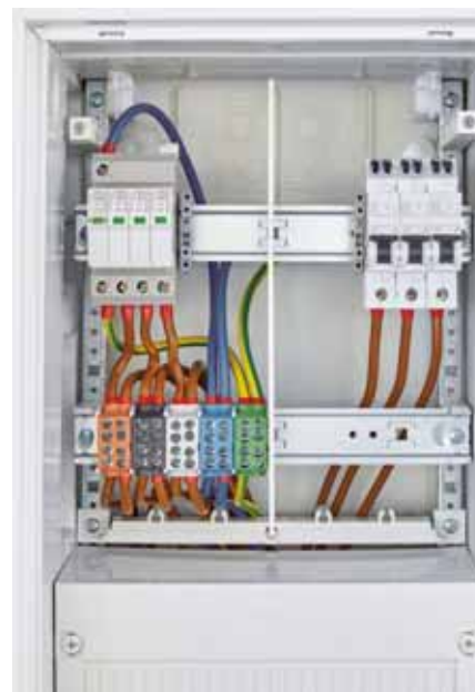
Installation im Verteiler (Quelle: PHOENIX CONTACT)
