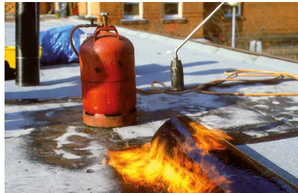
Abb. 1: Typische Zündquellen auf der Baustelle, Quelle: VdS 2216
