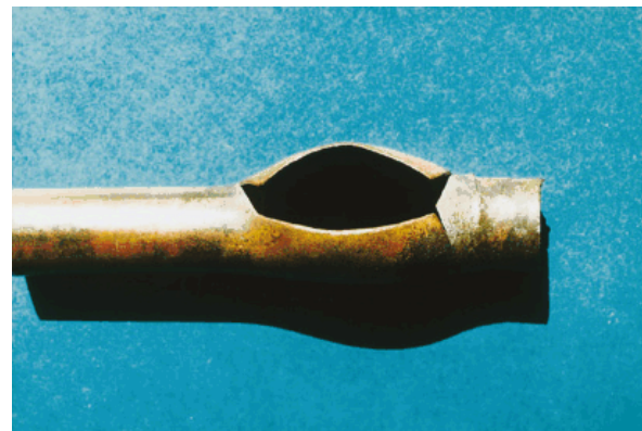
Abb. 9: Leitungswasserschäden durch Frost, Quelle: Schadenprisma 4/1997, Heiko Hupe
