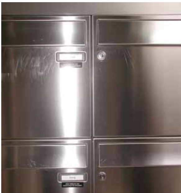
Abb. 10: Beispiel zerkratzter Oberflächen, Quelle: PLB Provinzial-Leben-Baubetreuungs-GmbH, Düsseldorf
