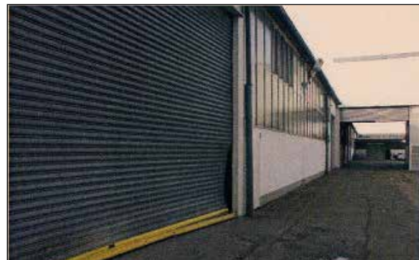
Abb. 19: Ein beschädigtes Tor (Quelle: HGI)
