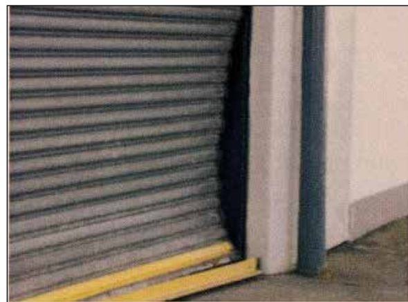
Abb. 20: Detailansicht eines beschädigten Tors (Quelle: HGI)
