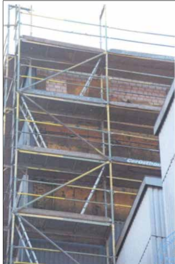
Abb. 16: Die beschädigte Fassade (Quelle: HGI)
