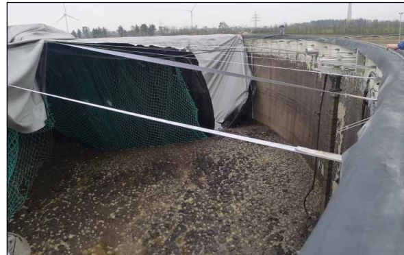
Abb. 24: Ein zerstörtes Membrandach (Quelle: Gothaer Risk-Management GmbH)
