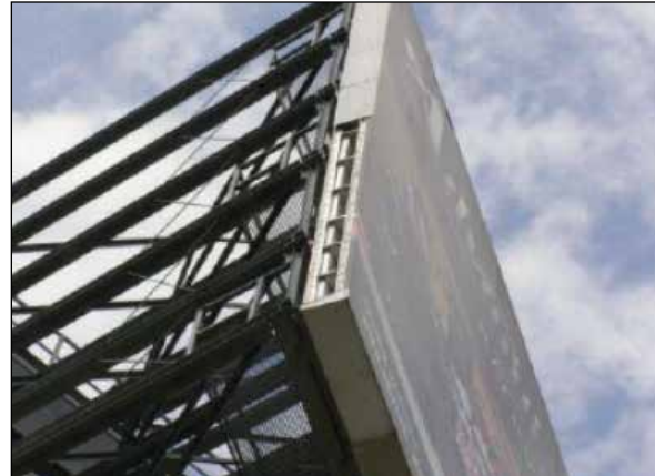
Abb. 22: Abgerissene Seitenabdeckung der Werbetafel (Quelle: R+V)
