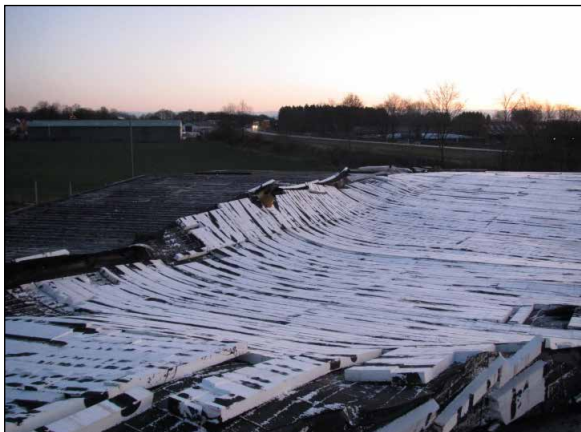
Abb. 12: Abgehobene Dachschichten der Halle 3 (Quelle: HGI)
