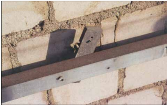
Abb. 17: Beispiel herausgerissener Befestigung (Quelle: HGI)
