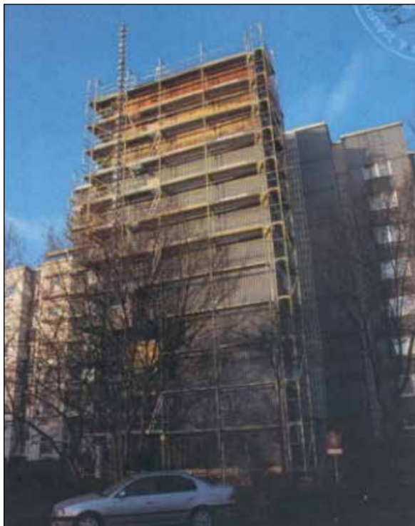
Abb. 15: Ansicht der beschädigten Fassade (Quelle: HGI)
