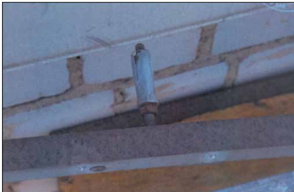
Abb. 18: Beispiel eines herausgerissenen Dübels (Quelle HGI)
