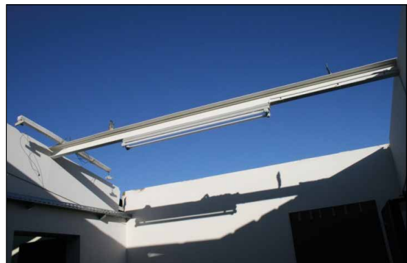
Abb. 11: Eine beschädigte Dachöffnung (Quelle: HGI)
