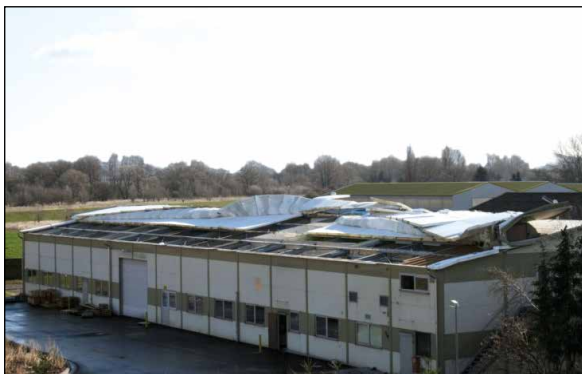
Abb. 8: Lagerhalle mit dem beschädigten Dach (Quelle: HGI)
