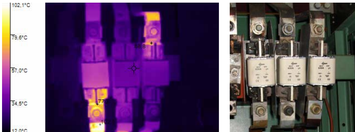
Thermisch auffällige Anschlüsse bei NH-Sicherungen (Quelle: BGHM)
