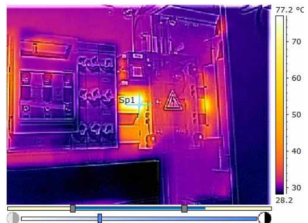
Bild 5: Display einer Thermografiekamera (Quelle: Lutz Erbe, VGH)
