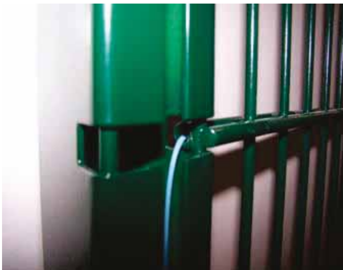
Abbildung 8-2: Detektionszaun mit eingezogenem Alarmdraht
