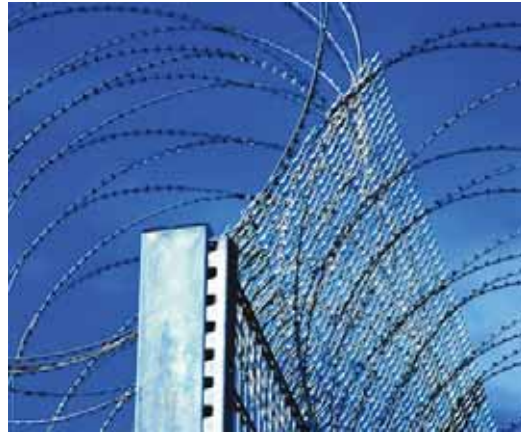
Abbildung 7-15: Kombiniertes Übersteigenschutz (Streckmetallmatte mit S-Draht-Rolle)
