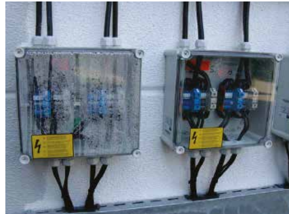
Bild 16: Kondenswasserbildung im Generatoranschlusskasten
