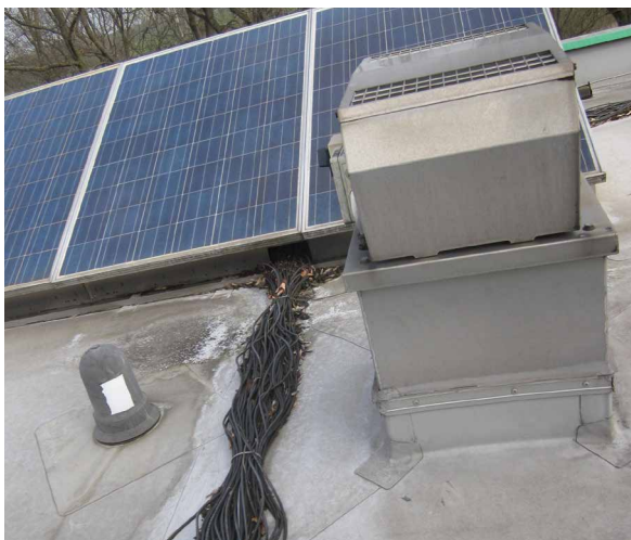
Bild 13: nicht fachgerechte Leitungsverlegung
