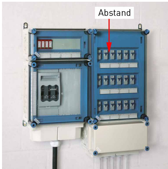
Bild 15: Verteiler für PV-Anlage
