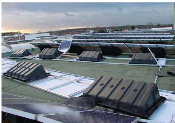
Bild 7: Sturmschaden durch Nichtbeachtung der Systemstatik
