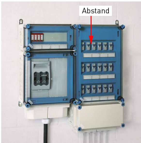
Bild 15: Verteiler für PV-Anlage
