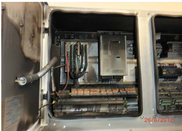
Bild 5-4: Mit Rauch kontaminierte Schalteinrichtung
