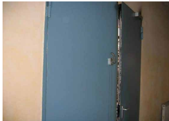
Bild 5-2: Ein Brandereignis von zwei Seiten betrachtet: Trotz des immensen Brandschadens (oben) hat die Brandwand mit der rauchdichten Brandschutztür (unten) dem Feuer standgehalten und eine Rauchausbreitung in den nicht vom Brand betroffenen benachbarten Bereich wirksam verhindert.
