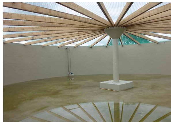
Bild 6: Holzkonstruktion im Nachgärer
