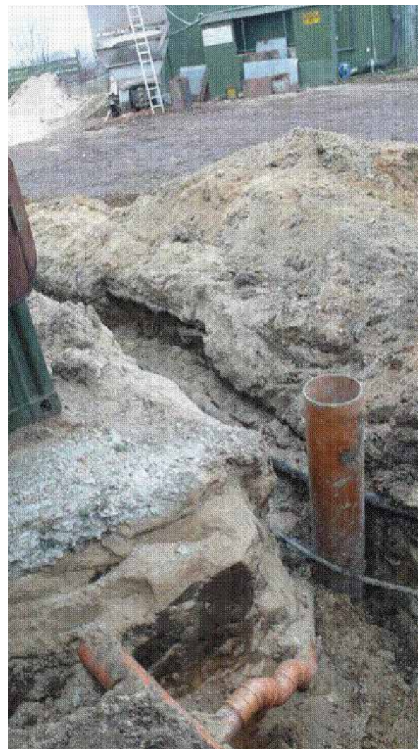
Bild 19: Unzulässiger Einsatz von KG-Rohren als Biogasleitung
