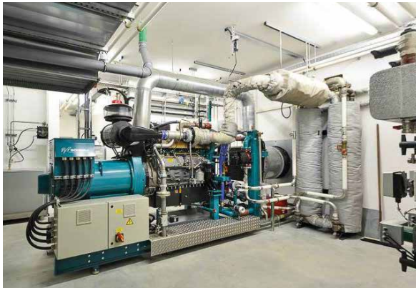
Bild 11: BHKW in Maschinenaufstellraum
