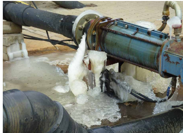
Bild 9: Durch Frost beschädigte Pumpe
