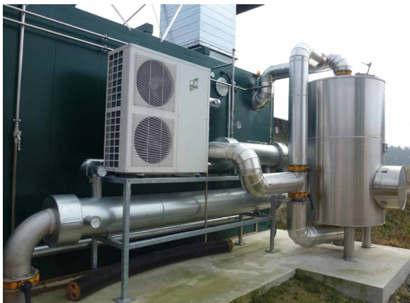
Bild 10: Gaskühlung und Gastrocknung
