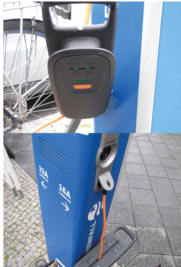
Bild 4: Ladeleitung im Einsatz
