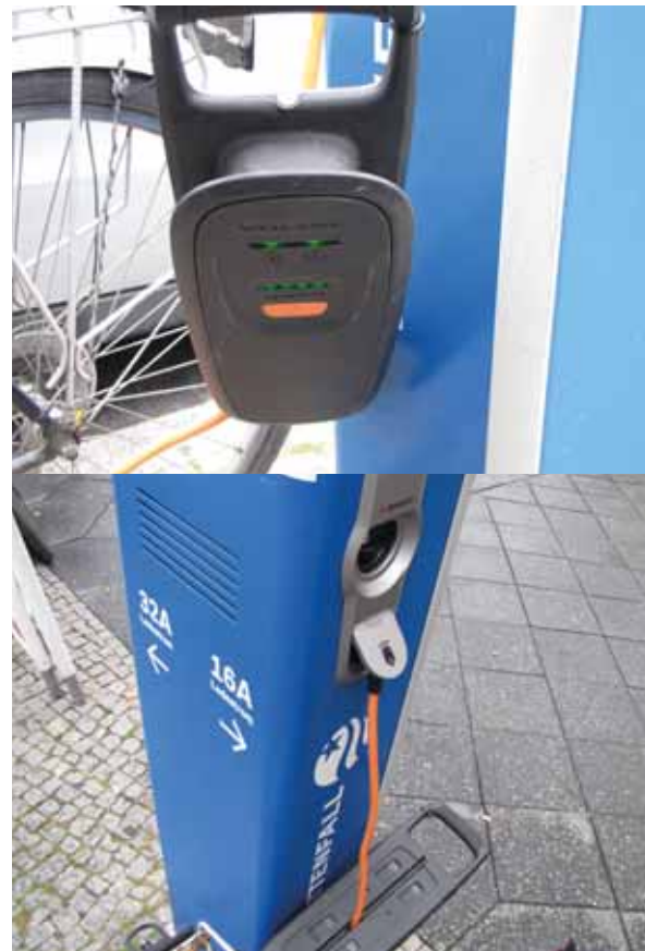
Bild 4: Ladeleitung im Einsatz
