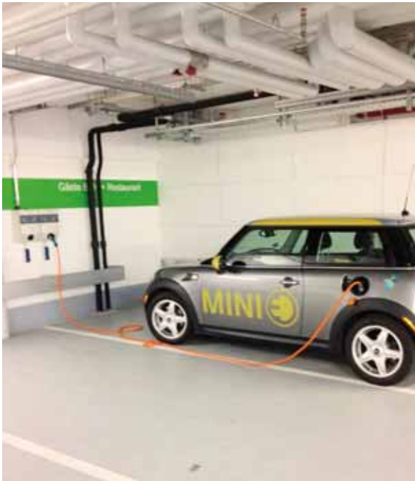
Bild 3: Ladestation in einer Garage
