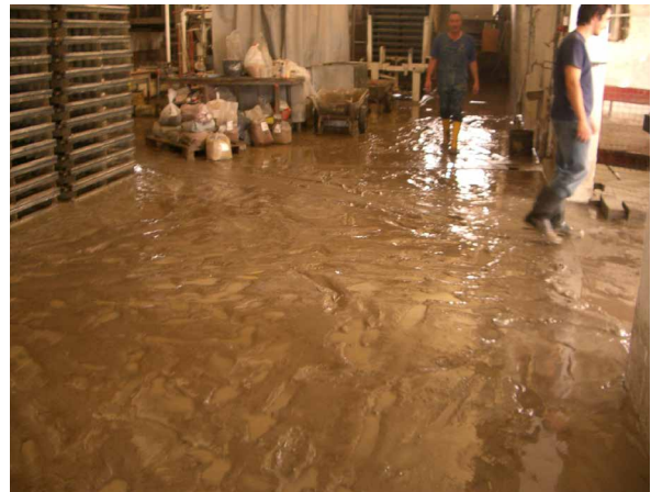
Abb. 8-5: Schlammablagerungen im Produktionsbereich (Quelle: Stangl AG)
