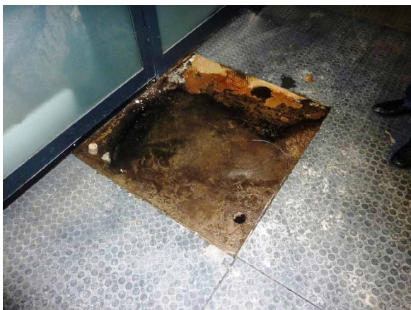
Abb. 8-22: Feuchtigkeit unter Bodenbelag (Quelle: Gotthardt Bausachverständige)
