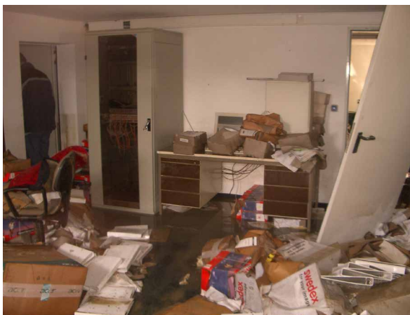
Abb. 8-3: Archiv und Serverraum im Untergeschoss (Quelle: Stangl AG)
