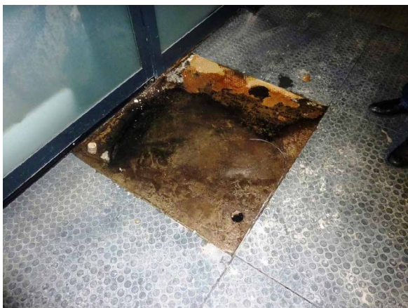
Abb. 8-22: Feuchtigkeit unter Bodenbelag (Quelle: Gotthardt Bausachverständige)
