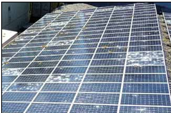
Abb. 12: Photovoltaik-Module, die zum Teil durch Hagelinschläge beschädigt wurden (Quelle: R+V)
