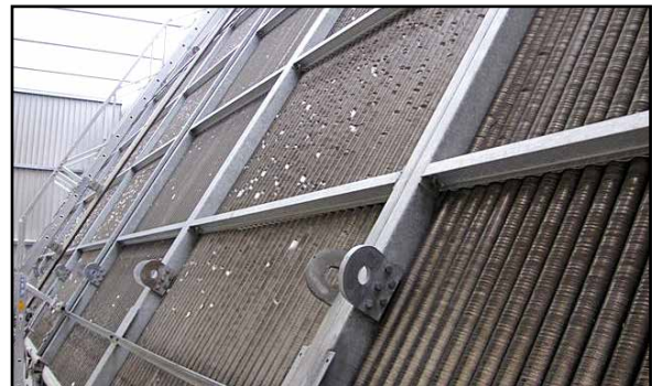
Abb. 17: Eine vom Hagel beschädigte Luftkondensatoranlage (Quelle: HDI)
