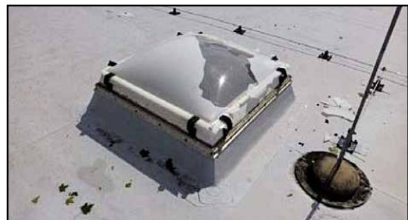
Abb. 20: Detailansicht einer beschädigten Lichtkuppel (Quelle: HDI)
