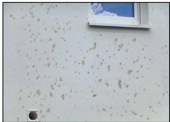
Abb. 10: Schäden an der Fassade (Quelle R+V)
