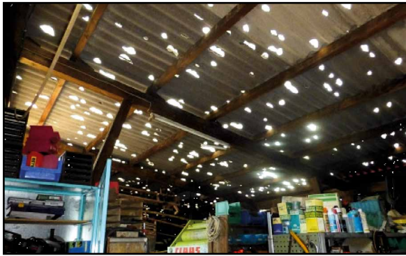
Abb. 7: Schaden an der Dacheindeckung einer Halle aus Zementfaserplatten durch Hagelsturm (Quelle: R+V)
