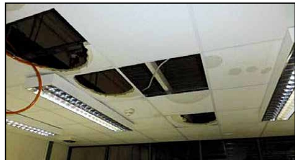
Abb. 21: Durchfeuchtete Decke infolge eingedrungenen Regenwassers (Quelle: HDI)
