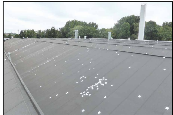
Abb. 3: Provisorisch verschlossene Hageleinschlaglöcher der Bitumendachabdeckung (Quelle: HDI)
