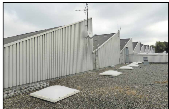
Abb. 4: Unbeschädigte Dachteile mit Kiesschüttung (Quelle: HDI)
