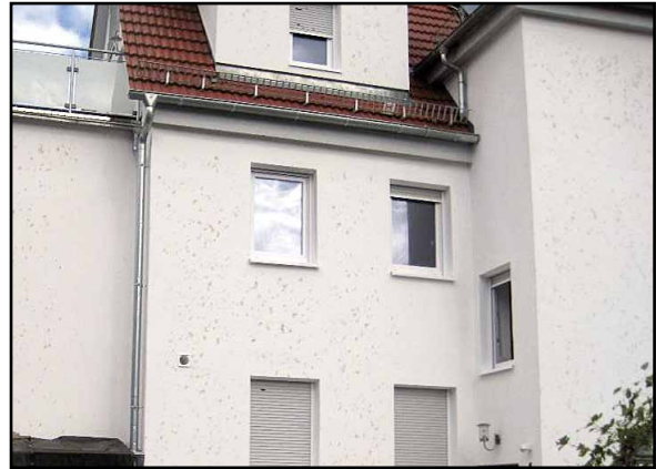
Abb. 9: Schäden an der Fassade und an Rollläden (Quelle R+V)
