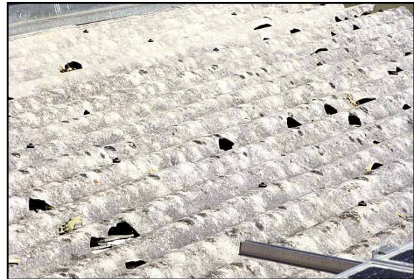
Abb. 14: Schäden an der Dacheindeckung der Halle durch Hagelkörneinschläge (Quelle: R+V)
