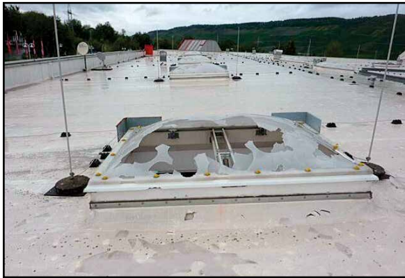
Abb. 15: Zerstörte Lichtkuppeln und Kunststoff-folienabdeckung (Quelle: R+V)
