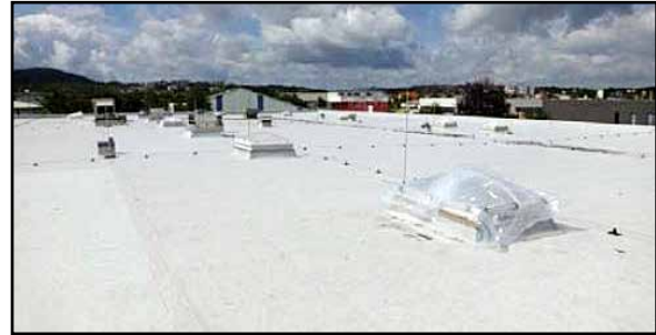
Abb. 19: Vom Hagel beschädigte Lichtkuppeln, zur Schadenminderung mit Folie abgedeckt (Quelle: HDI)
