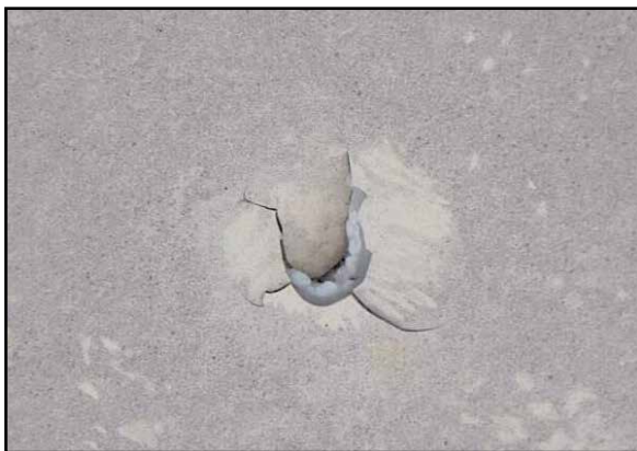
Abb. 16: Einschlagsloch in der Fassade (WDVS) (Quelle: R+V)
