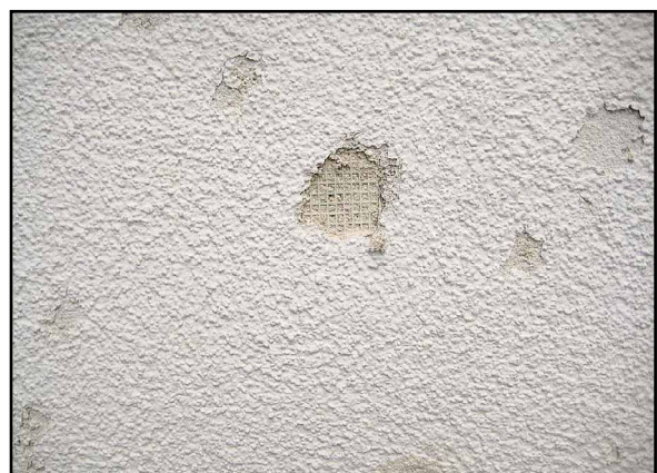
Abb. 11: Schäden in der Putzschicht des WDVS-Fassadensystems (Quelle R+V)
