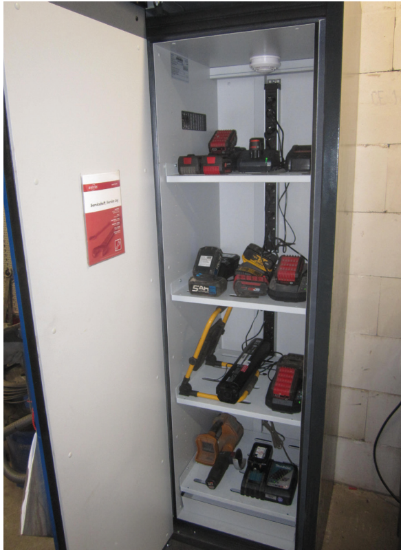
Bild 1: Ladeschrank zur Unterbringung von Ladegeräten und Akkus
